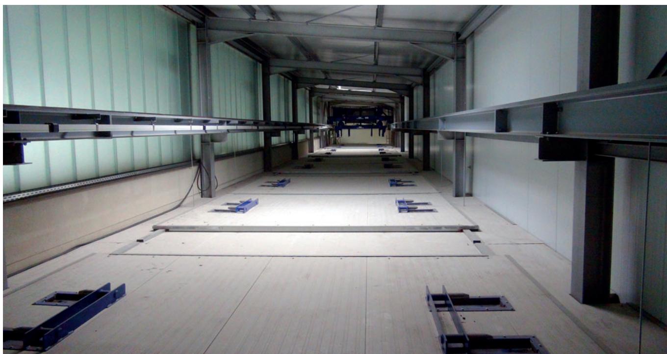
Coup d'œil dans la nouvelle chambre de durcissement de Rail.One à Coswig.
