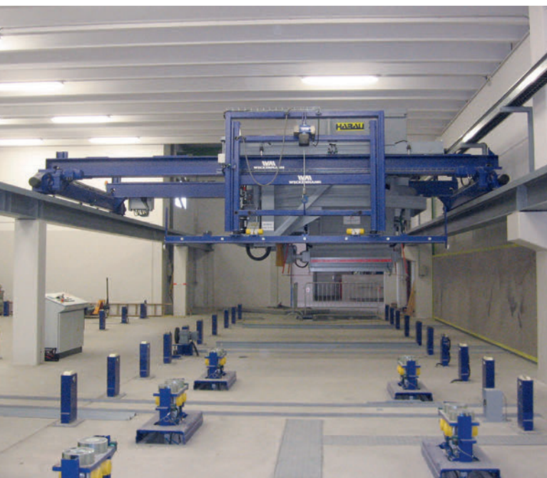
Verdichtungsstation MagVib - Einsatz in neuer Anlage
