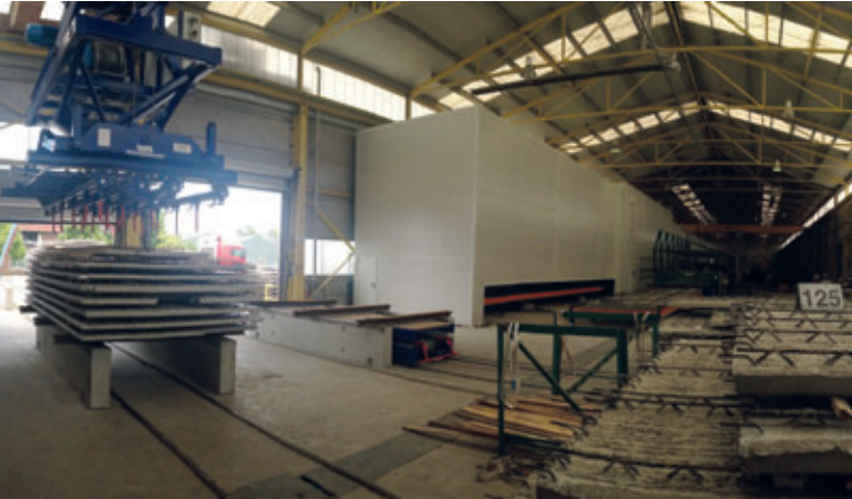
Vier Stapelplätze für Elementdecken mit zwei Ausfahrwagen im Halbautomatikbetrieb
