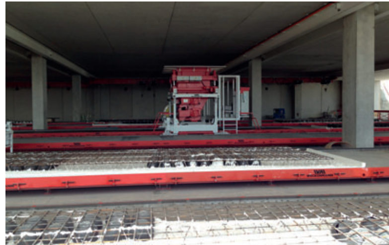
Un vistazo a la nueva sala de Danstek producción: Weckenmann suministró varios cientos de metros de líneas de producción con la última tecnología de maquinaria.
