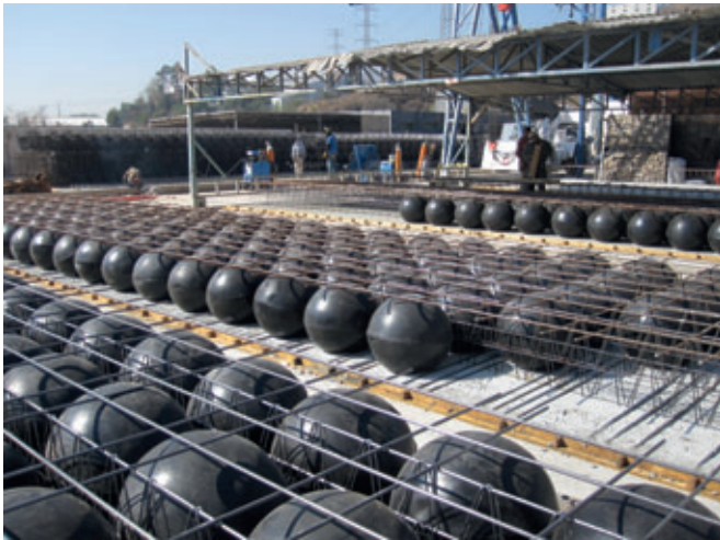
En la nueva producción, la empresa mexicana produce sobre todo losas aligeradas de dos ejes, debido a su cuerpo redondo de desplazamiento también se denominan BDM.
